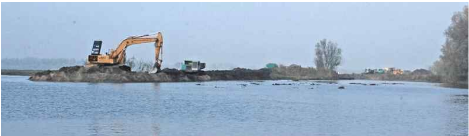
Graven van de dijkopening in het Gat van de Lepelaar. Foto: Cor Huijgens
